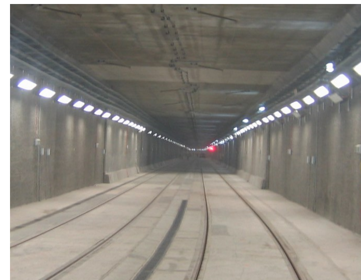
Sygnalizacja w tunelu
